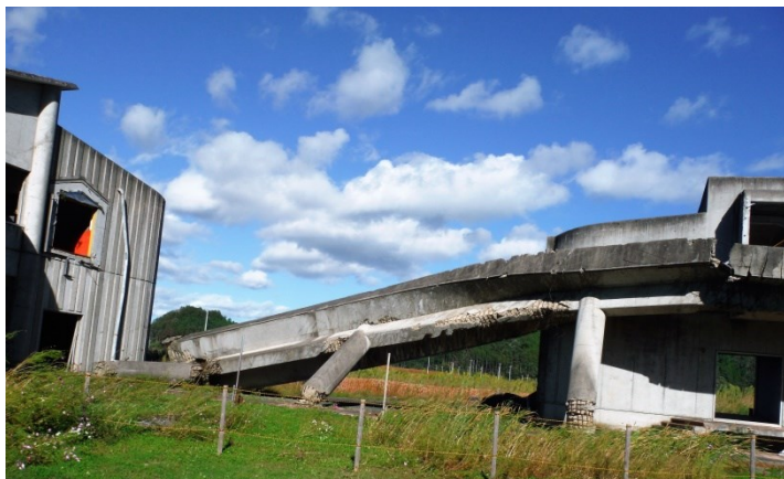
震災で破壊された大川小学校の校舎
